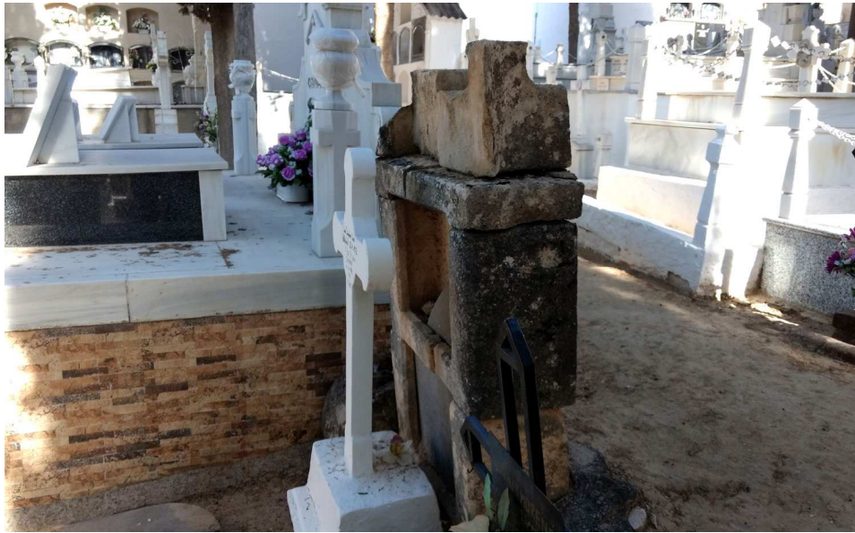
Monumento funerario antes de la restauración.
